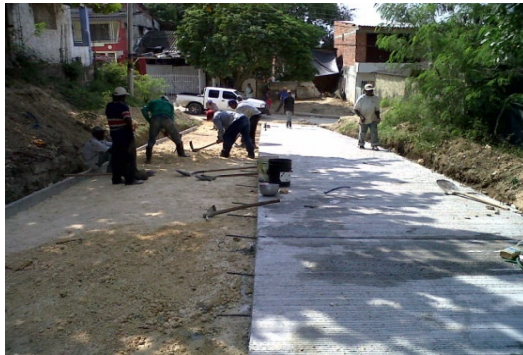
Construcción de Pavimento Rígido en la Calle los Besos entre Calle Caldas y Calle Ruben Bermudez
