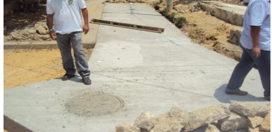
Construcción De Pavimento En Concreto Rígido De La Calle Las Flores, Tramo Entre Canal El Tigre Y Calle La Arrocera, Barrio Olaya Herrera Sector 11 De Noviembre En
